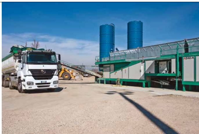
2. La produzione di asfalto a freddo avviene senza problemi anche fra un carico e l'altro di misto cementato o altri conglomerati cementizi
