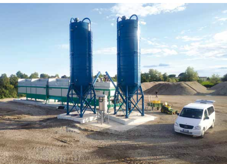
8. Il posizionamento dell'impianto della Eco-Works è stato pensato per ottimizzare la funzionalità sia in caso di lavoro stabile sia per un eventuale trasporto
